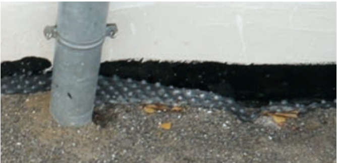
Planungsmangel einer Bauwerksabdichtung oberhalb der Geländeoberkante
